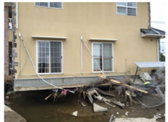
写真-1 洪水氾濫流による住宅の洗掘被害
