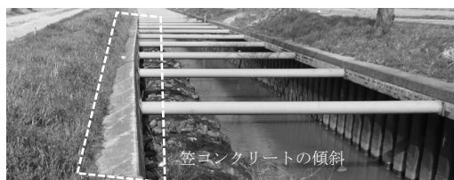
(b) 鋼矢板護岸の座屈による矢板頭部の傾斜
