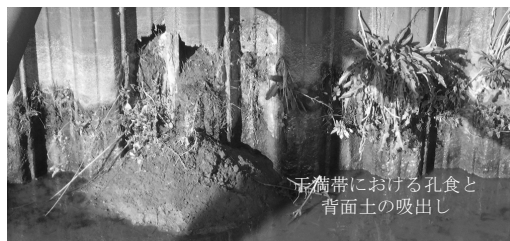
(a) 孔食からの背面土の吸出し
