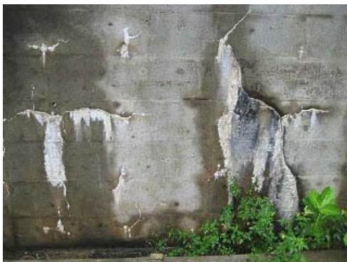
写真-2 ダム表面に生じた変状
