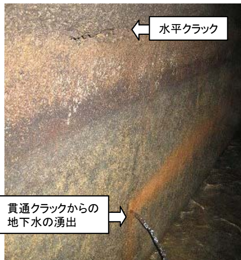
写真-3 水路側壁の劣化
