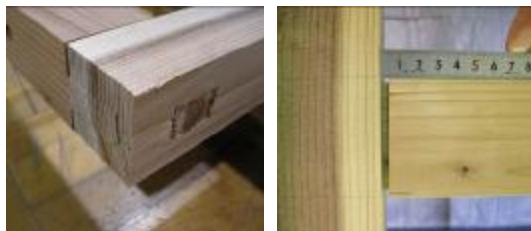
(a) 隅角部仕口の割れ (b) 端部の抜け出し
