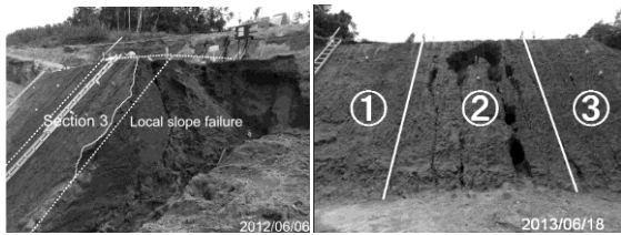
写真-2 崩壊後の盛土の状況 (FE-2011)
