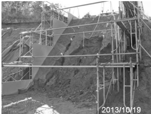
写真-3 崩壊後の盛土の状況 (FE-2012)
