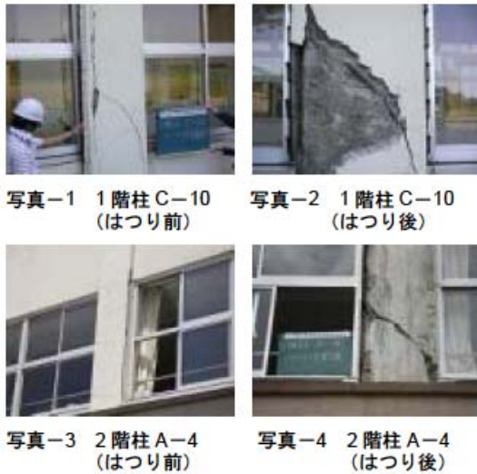
図 1 S 小学校のせん断破壊した柱例
