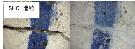
写真 3 通水試験前後のひび割れ部 (それぞれ、左:通水前、右:通水後)
