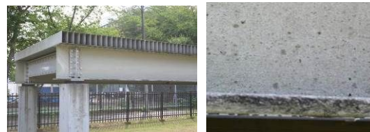
図-4 黒色点状の変状 (供試体 No.8, つくば)
