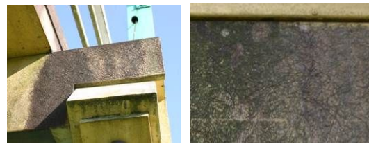
図-5 黒色汚れ状の変状(供試体 No.2, つくば)
