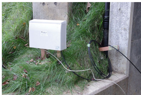
図 3 メディアコンバータ収容箱設置状況
