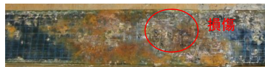
図-8 炭素繊維シートの損傷状況
