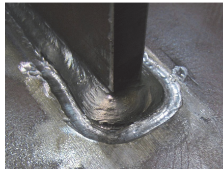
図-3 ICR 処理後の溶接止端近傍の様子
