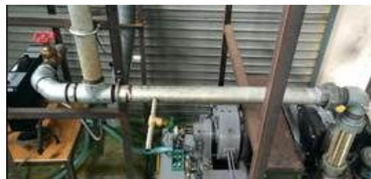
図10 排ガスサンプリング部
