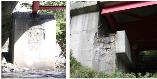
橋台① 橋台② 図8 スケーリングが顕著な橋脚例
