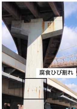
図2 腐食ひび割れを有する RC 柱
