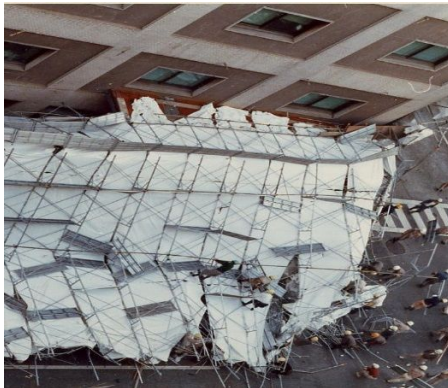
図1 風による足場の倒壊災害
