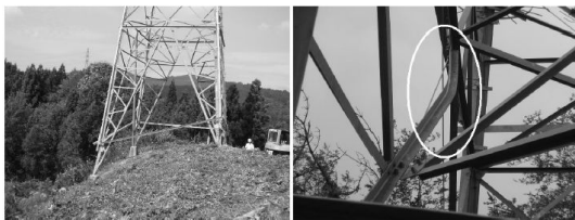
図-1 地盤変状による脚部不同変位 (左手前の脚) 図-2 脚部不同変位による部材損傷事例
