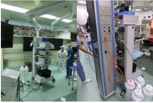
図2 手術室内のシーリングアームで懸垂されたカートと接続部（[TF]）
