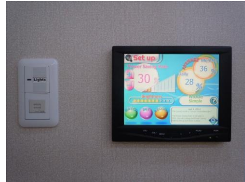
図5 調光コントローラ(操作パネル)
