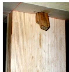
NPJ-Cw-S-70-S3 写真1 破壊性状 (鼻栓の割れ)
