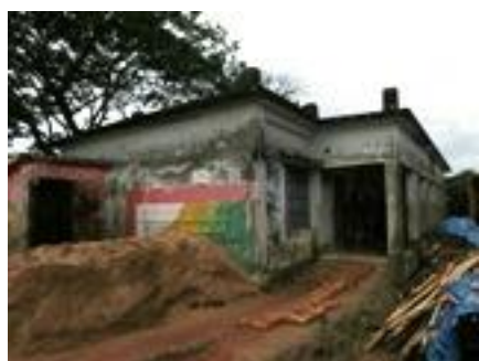
図3. 調査対象（被災した小学校）
