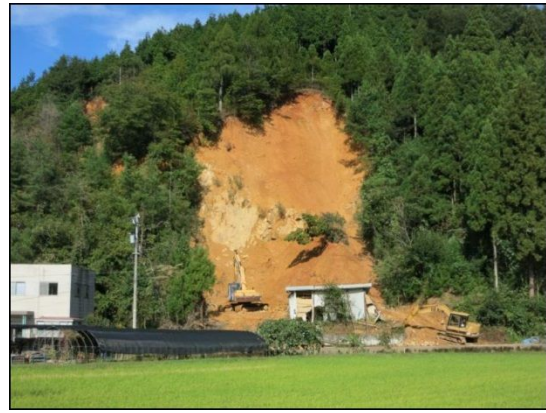
図1 2013年台風18号を誘因として発生した越前町八田の斜面崩壊
