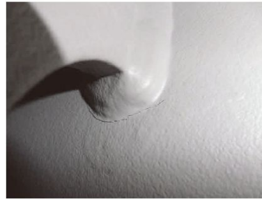
図-7 まわし溶接部に生じる疲労き裂
