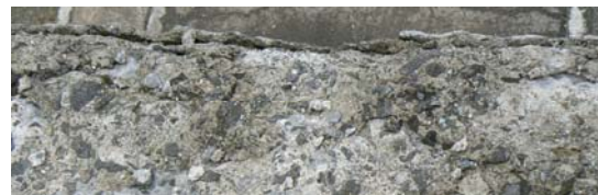
c) ポップアウトによる表層部の浮きと表層スケーリング
