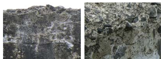
a) 網目状ひび割れ b) ポップアウト
