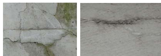
a) 網目状ひび割れ b) ポップアウト
