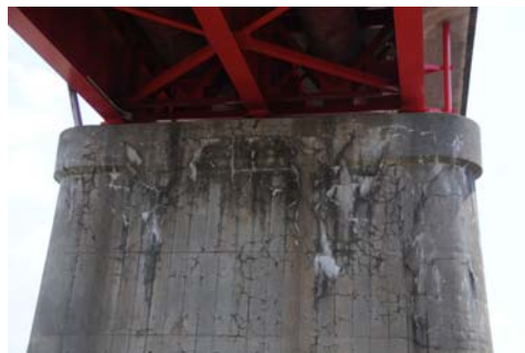
(a) ASRで劣化した橋脚
