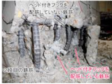
図 10 : 軸方向鉄筋はらみ出し形状の違い
