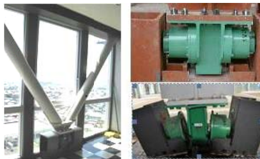
ブレースの下方にオイルダンパー設置 上：破損前のダンパー 下：破損後の状況
