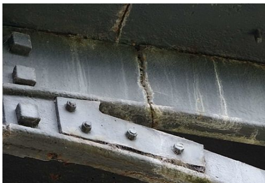
写真5 アイアンブリッジのアーチ頂部付近のクラックと補強
