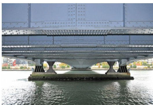
写真3 永代橋に追加設置された水平支承
