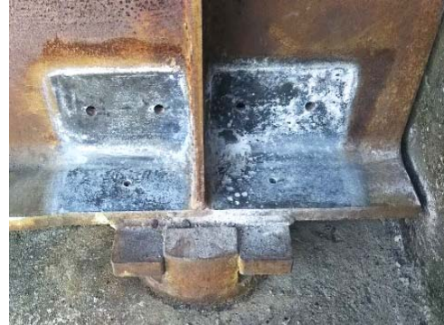
2.5 年後の防食状況
