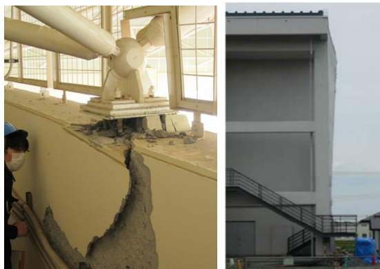
図1 鉄骨置屋根構造支承部の被害例
