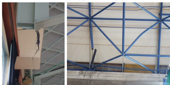
図9 2016 熊本地震における体育館被害
