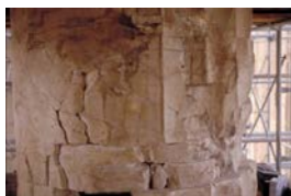
写真 4.9.1 大理石組積柱の歴史火災による損傷
