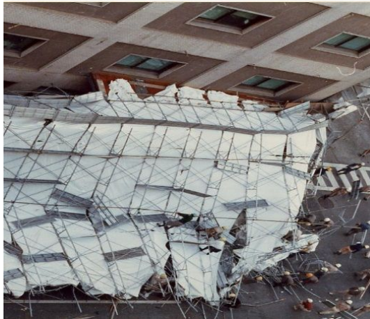
図 1 風による足場の倒壊災害
