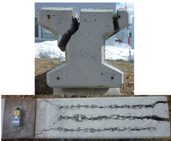
図-5 ひび割れ発生状況 (上：断面、下：桁端部平面)
