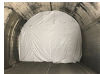
図 1 トンネル内閉鎖シート
