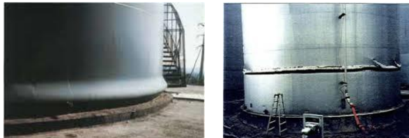
図1 鋼製容器構造の損傷事例
