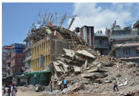
写真 1 倒壊した URM 壁付き建物 (2015 年ネパール地震)
