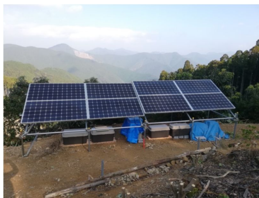
写真1 土壌温暖化処理の電源となるソーラーパネル
