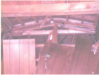
写真2 梁を折損した圧縮筋か
