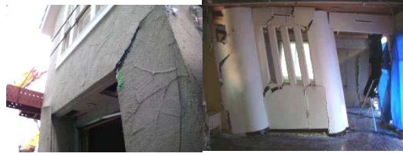
写真5 外装材の大亀裂 写真7 真内装材の大亀拡大
