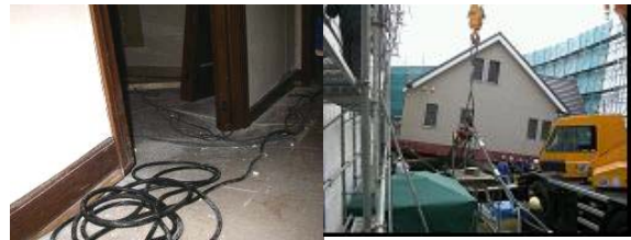
写真6 間仕切り壁の沈み 写真7 建物の倒壊
