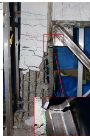
図 9 柱の変形状態と鉄骨の破断
