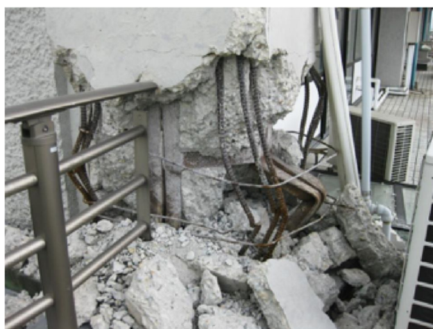
図 2 壁際の柱の破壊 (鉄筋・鉄骨の座屈・破断)
