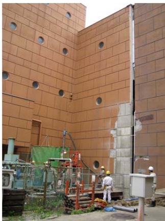
図1 杭基礎被害により生じた建物の相対変位および対策工事の様子
