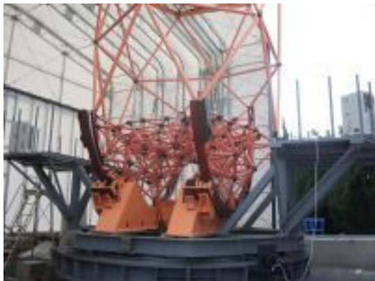
(仮ドーム内の望遠鏡架台と除湿機)
