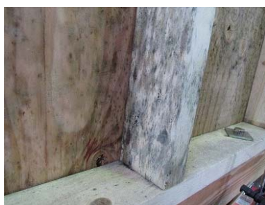
写真3 枠組材のカビ
