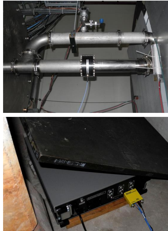
図 3: ビームラインに設置されたビーム電流検知部（上）と位相同期型アンプ（下）。
