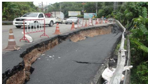
写真-1 道路斜面崩壊事例（タイ国道 4233 号）
