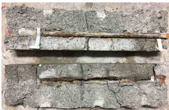
図 - 4.4.2 ReCF-1.0 の鉄筋の腐食状況
