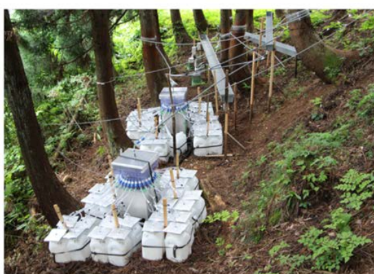
図2 雨水ディストリビューターの設置状況
