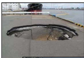
図1 鹿島港湾岸壁陥没 (出展：鹿島港湾・航空整備局)
