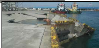
図2 相馬港岸壁倒壊
