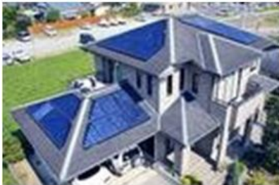
図 1 . 住宅用太陽光パネル
