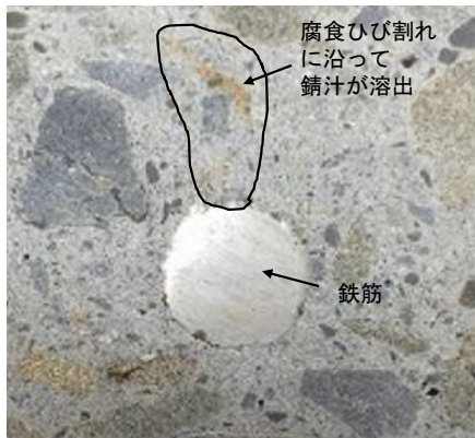
写真-2 ひび割れの様子（4週後）
