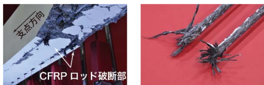
(a) 左側スパン底面の状況 (b) CFRP ロッド破断部の状況
