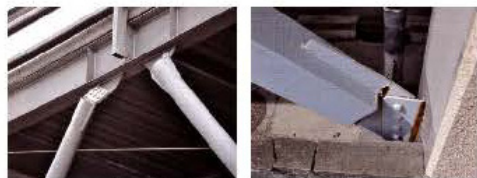
図 1 ブレース構造の被害事例
